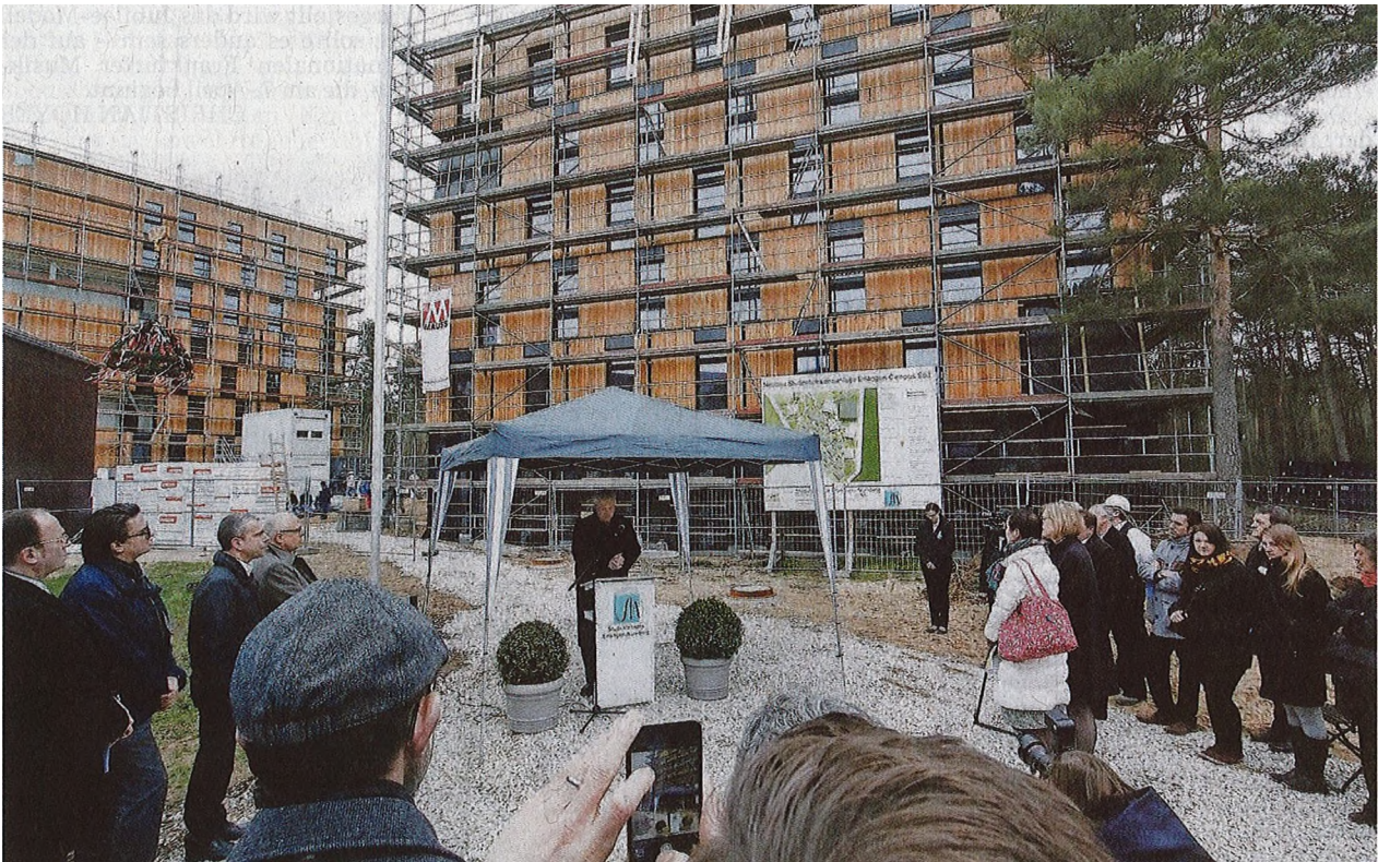
Nach knapp einjähriger Bauzeit konnte jetzt an der neuen Wohnanlage „Campus-Süd“ Richtfest gefeiert werden. Insgesamt 410 Wohneinheiten sollen hier geschaffen werden. Foto: Hubert Bösl
